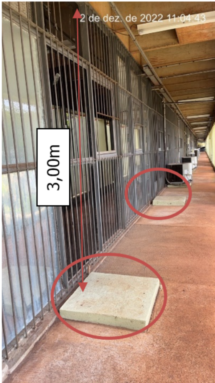
Figura 01 – Ponto de instalação das condensadoras das salas de descanso
