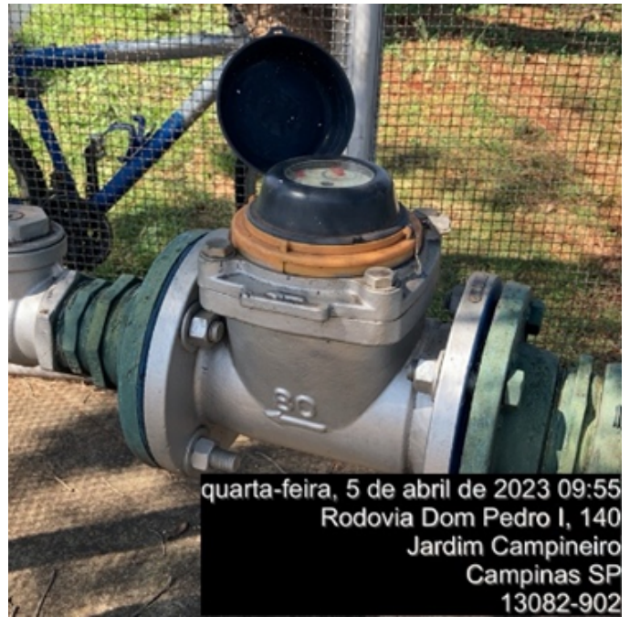
Figura 08 – Hidrômetro do Poço Local 002 DAEE 277- 0564
