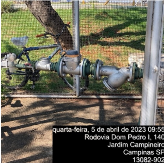
Figura 07 – Cavelete do Hidrômetro do Poço Local 002 DAEE 277-0564
