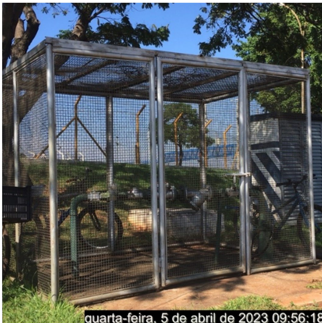
Figura 06 – Instalações do Poço Local 002 DAEE 277-0564
