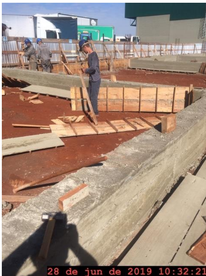
Figura 13 – Exemplo de superfície que não será aceita para elementos de concreto aparente
